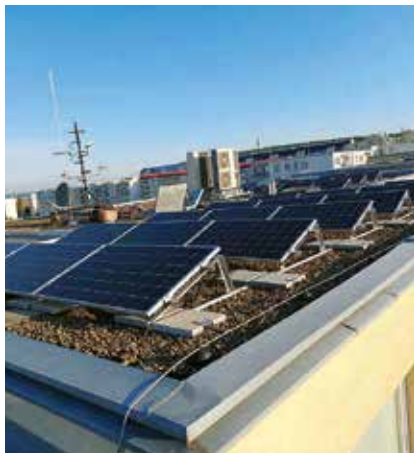
Celkový pohled na fotovoltaiku a tepelné čerpadlo na střeše domu
