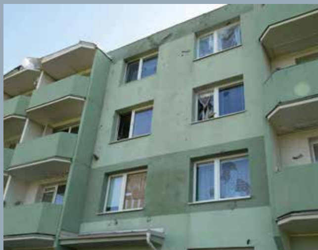
Stav po tornádu
