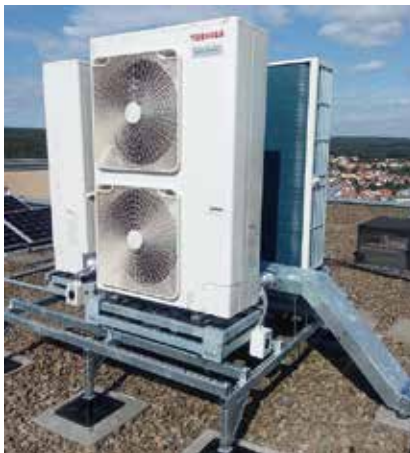
Tepelné čerpadlo vnější jednotky na střeše
