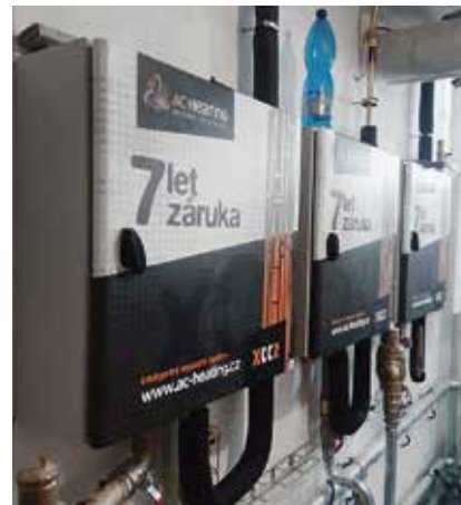
Vnitřní jednotky TČ v suterénu
